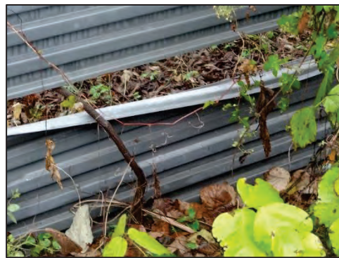
写真 5.3-13 沈降した防雪板
