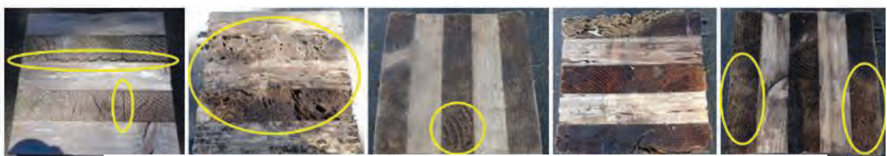
写真 1.1-4 地盤環境・亜熱帯(都城) キュービック供試体の劣化状況
