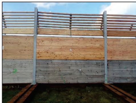
写真 5.3-3 塗装の有無による経年劣化の検証
