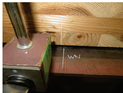
(b) 加力側小梁-北側CLTパネルのずれ
