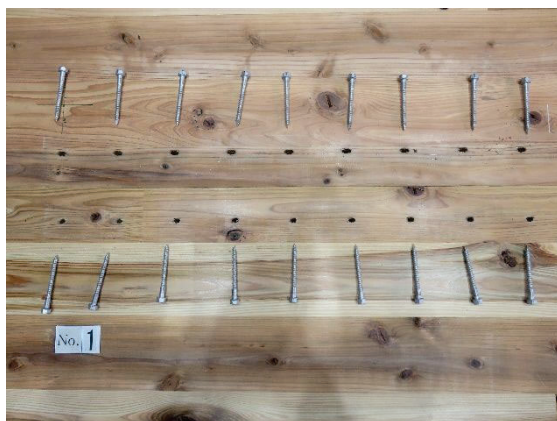
(a)ビスの状況 [スプライン接合西側端部]
