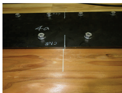
(k) スプライン接合部のずれ [南東側]
