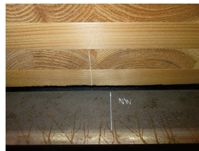
(c) 固定側大梁-北側CLTパネルのずれ [西側]
