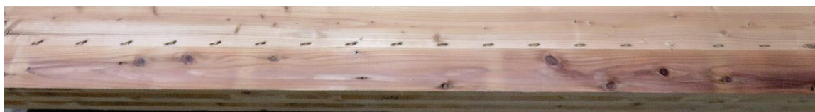
(g)ビス孔の状況 [固定側大梁－北側CLTパネル(西側)]
