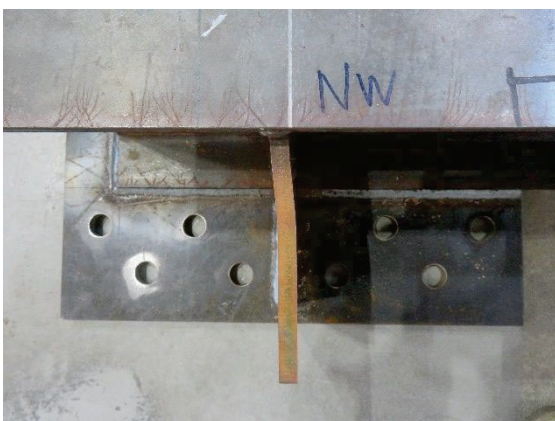
(g) 固定側大梁ガセットプレートの状況 [西側]
