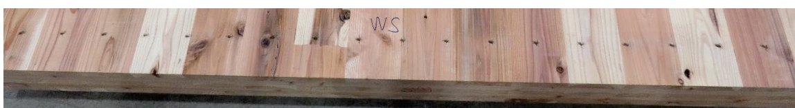
(e)ビス孔の状況 [加力側小梁－南側CLTパネル]
