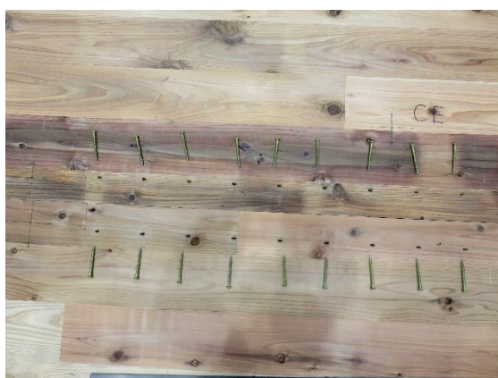
(c)ビスの状況 [スプライン接合東側中央部]
