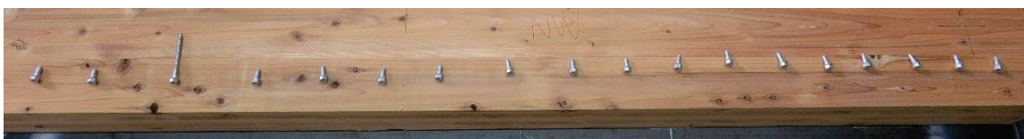
(g)ビスの状況 [固定側大梁－北側CLTパネル(西側)]
