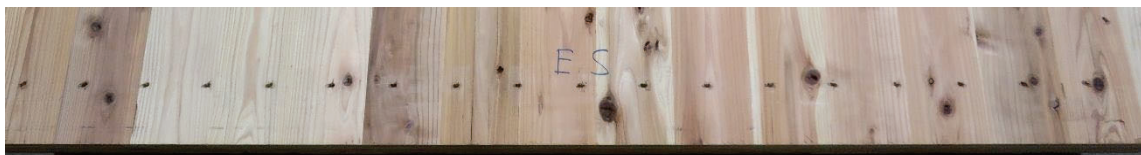
(b)ビス孔の状況〔非加力側小梁－南側CLTパネル〕
