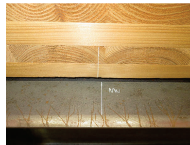
(c) 固定側大梁-北側CLTパネルのずれ [西側]
