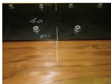
(k) スプライン接合部のずれ [南東側]
