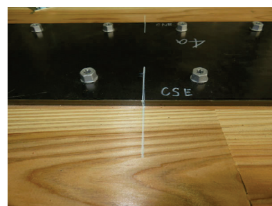
(l) スプライン接合部のずれ [北西側]
