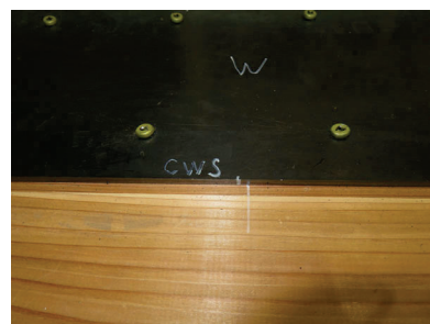
(i) スプライン接合部のずれ [南西側]
