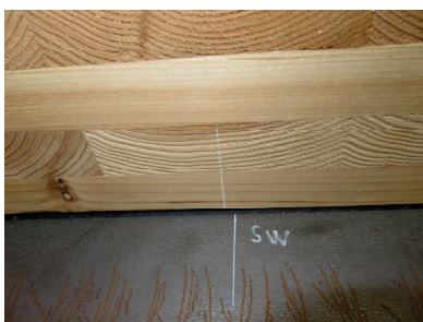
(h) 加力側大梁-南側CLTパネルのずれ [西側]
