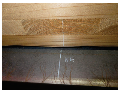
(d) 固定側大梁-北側CLTパネルのずれ [東側]
