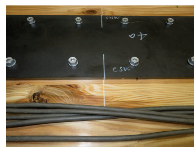
(i) スプライン接合部のずれ [南西側]
