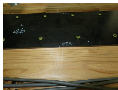
(l) スプライン接合部のずれ [北西側]
