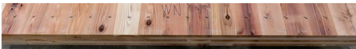
(f)ビス孔の状況 [加力側小梁－北側CLTパネル]
