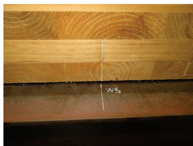
(a) 加力側小梁-南側CLTパネルのずれ
