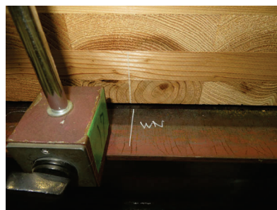
(b) 加力側小梁-北側CLTパネルのずれ
