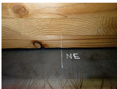
(d) 固定側大梁-北側CLTパネルのずれ [東側]
