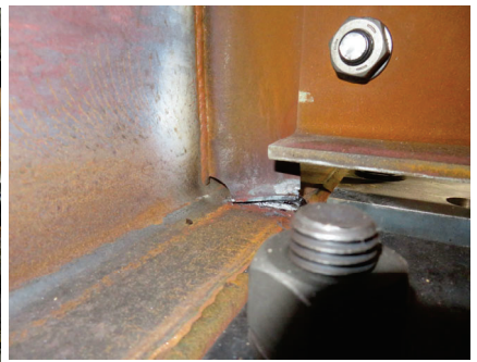
(d) 固定側大梁ガセットプレート 溶接部の曲げ変形・破断
