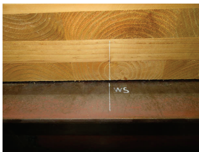
(a) 加力側小梁-南側CLTパネルのずれ
