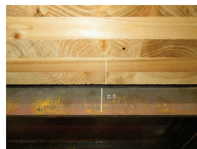
(f) 非加力側小梁-南側CLTパネルのずれ
