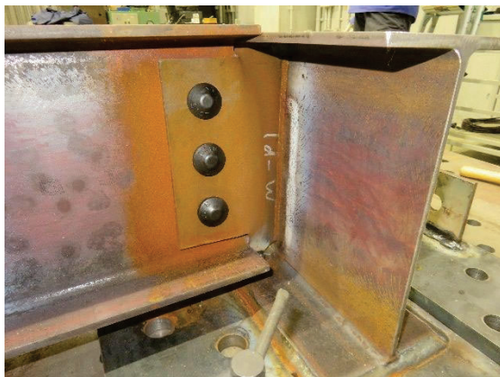
(a)固定側大梁－非加力側小梁接合部の状況
