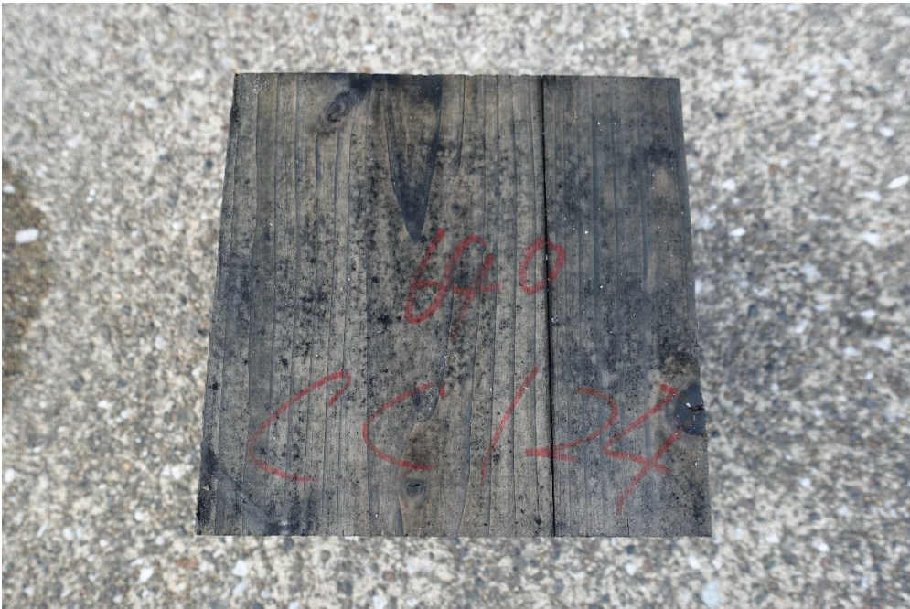
写真 4.1.6-3 幅はぎ部分に隙間
