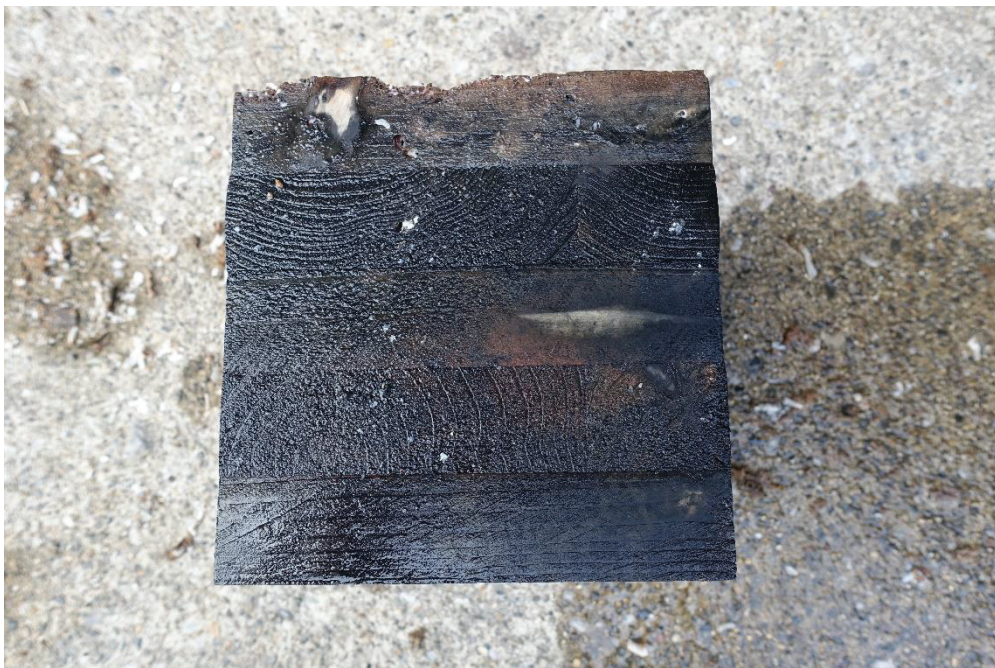
写真 4.1.4-4 土中部分は黒色に変色
