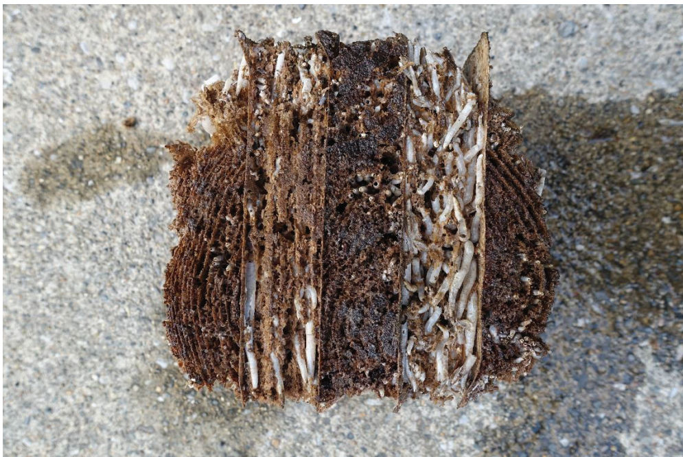
写真 4.1.1-4 接着層を残して原形を留めていない
