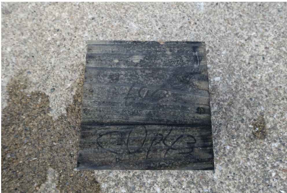
写真 4.1.6-1 幅はぎ部分に隙間
