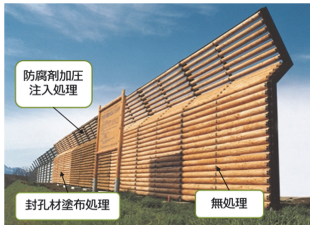
図 2.1-12 別海町町道に設置した木製防雪柵(平成 16 年度設置当時)
