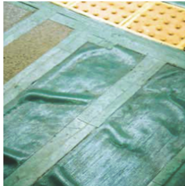
写真 2.2-2 波打つゴムマット
