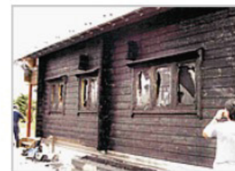
隣家から延焼したため、隣家側の外壁表面は炭化しました。
