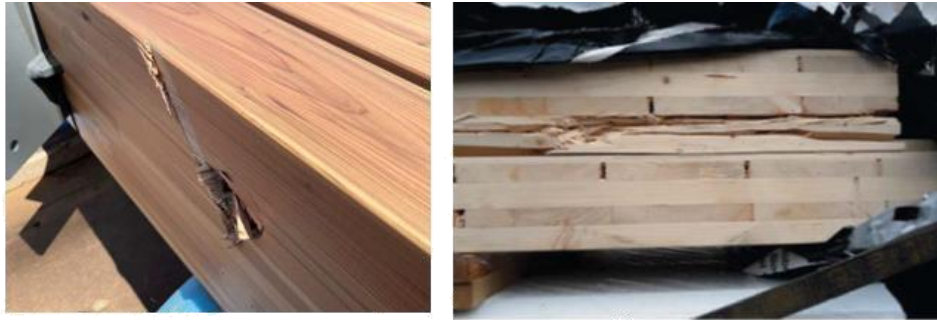
写真 破損の生じている例
