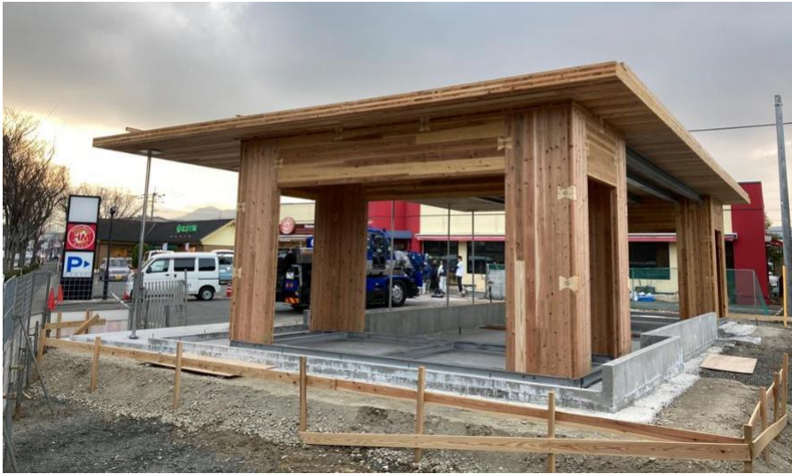
写真 同型店舗の CCU 構造体
