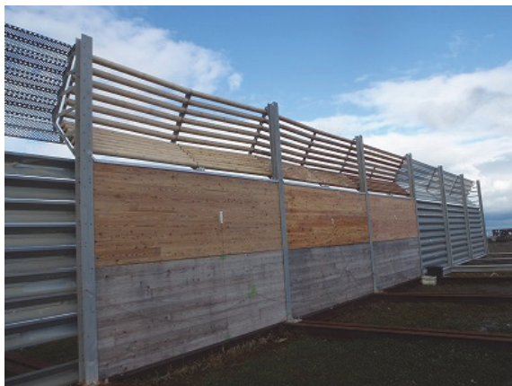
写真 2.3-1 防雪柵の設置状況(風下側)
