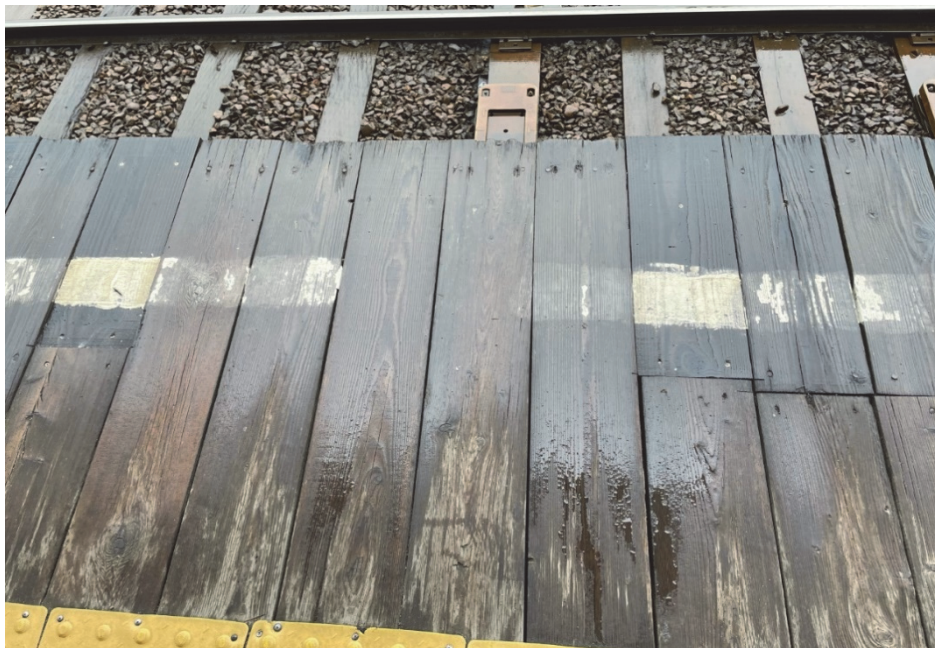
写真 3.2-2 同駅プラットフォームの表面
