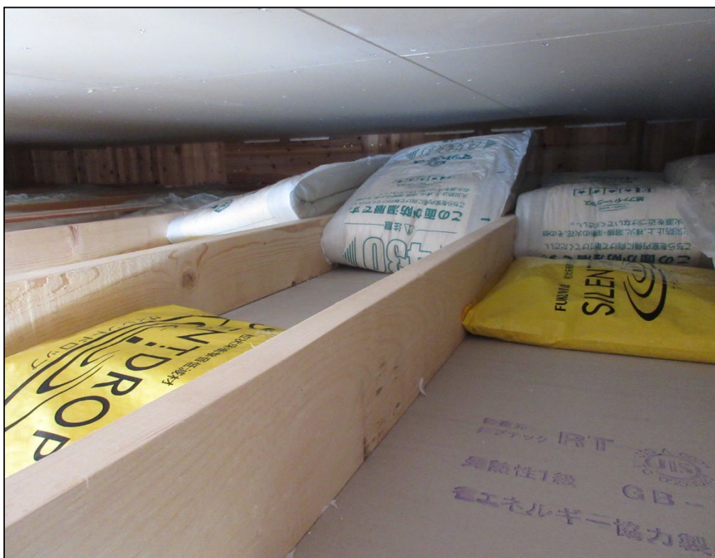
(2)天井遮音粒材およびグラスウール（天井裏）
