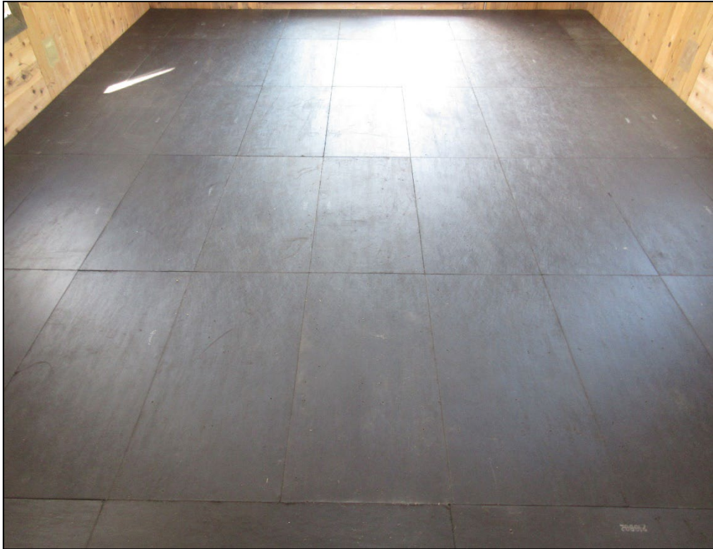
(5) アスファルト系制振マット
