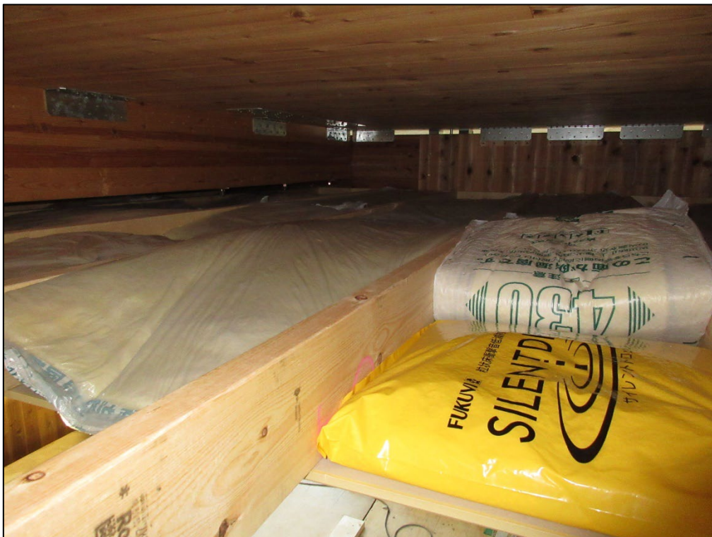
(2)天井遮音粒材およびグラスウール（天井裏）
