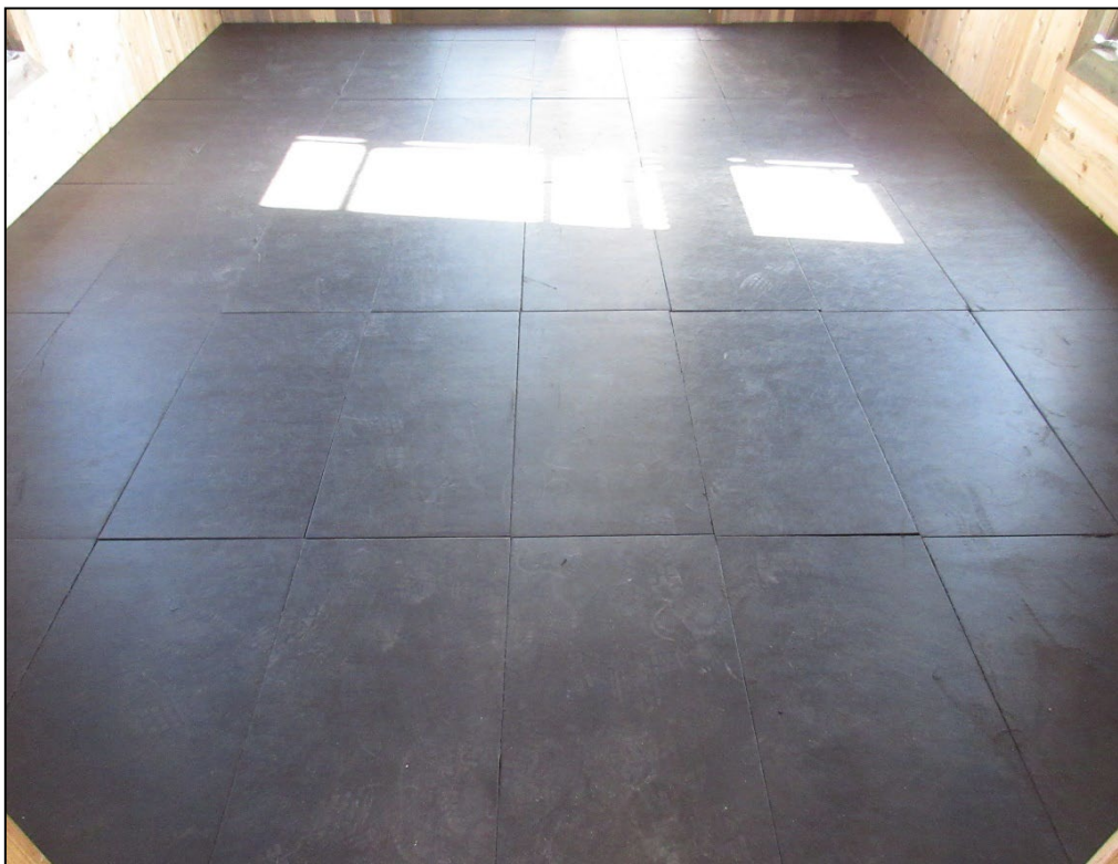
(2) アスファルト系制振マット
