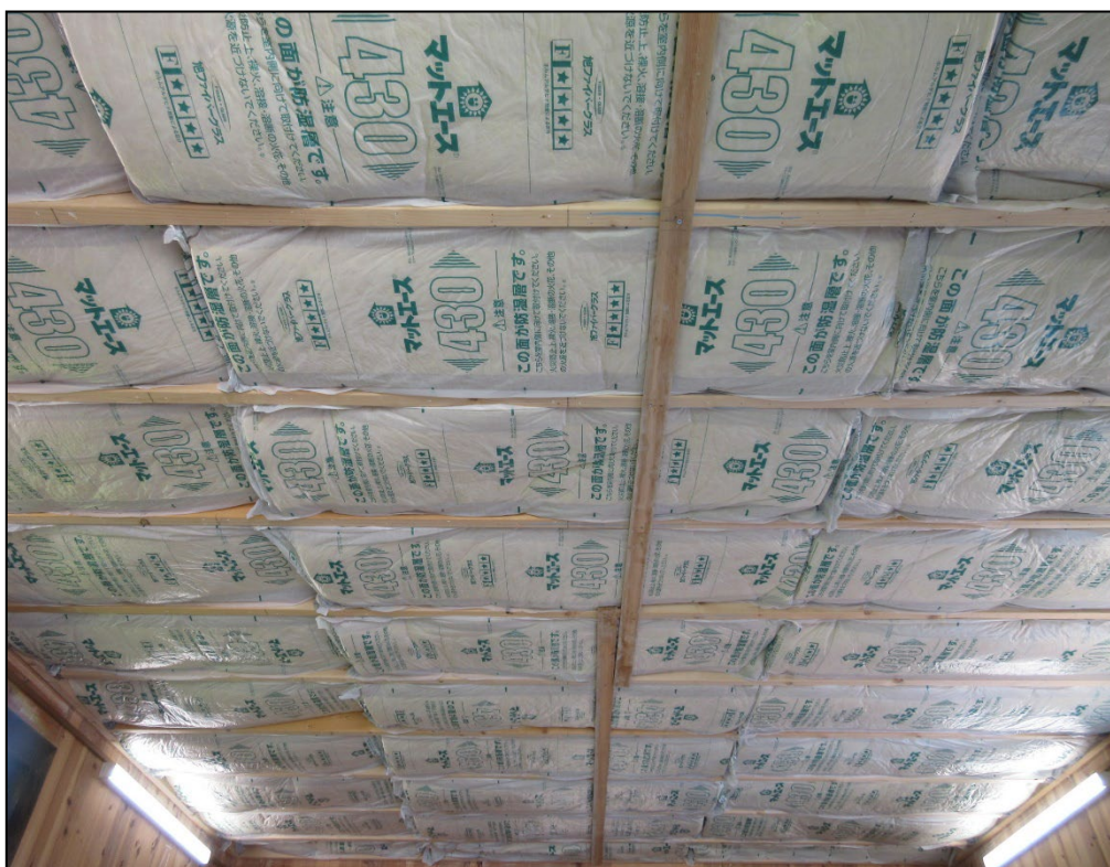
(2)グラスウール（天井裏の吸音材）
