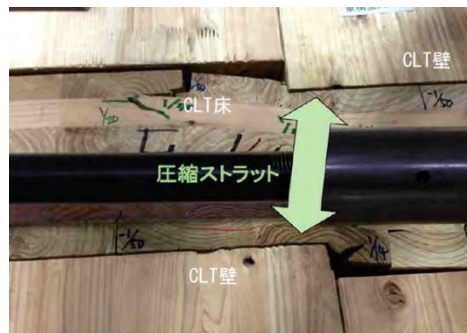
図 3.2.1-13 圧縮ストラット効果（連続壁パネル継ぎ目位置における床パネルの面外変形状態）
