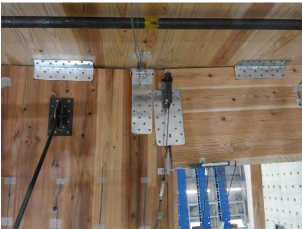
垂壁-袖壁接合部
