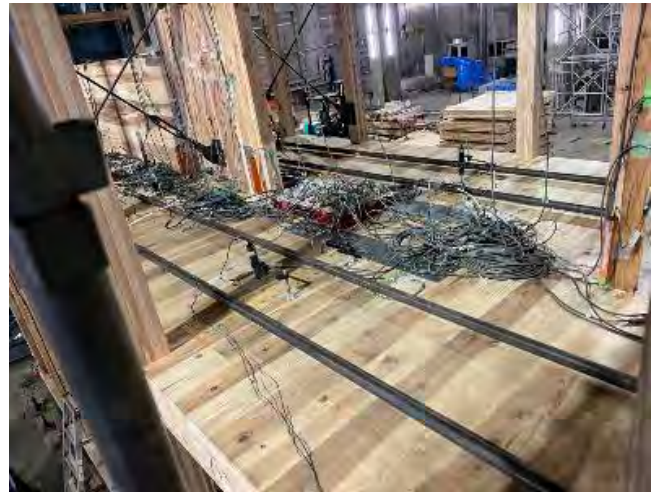
2F ケーブル接続状況
