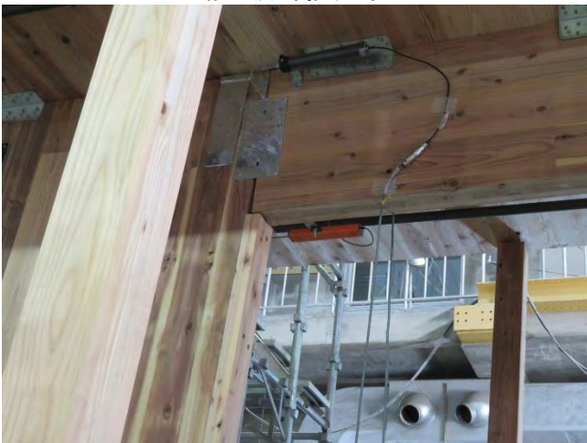
垂壁-袖壁接合部
