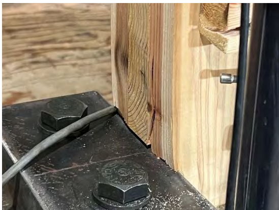
-1/15rad 時 CLT の割れ
