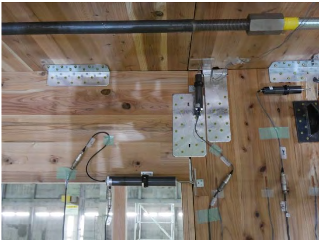
垂壁-袖壁接合部
