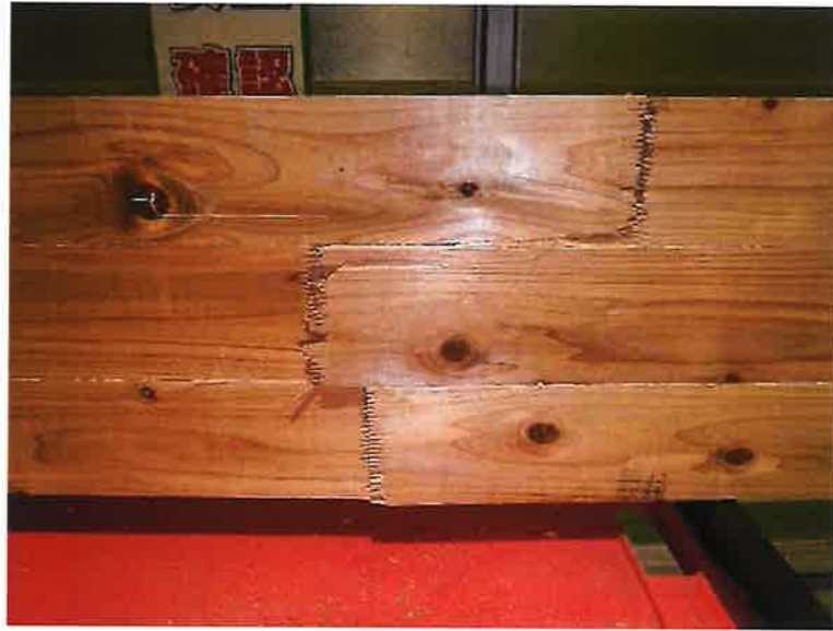
図 7 フィンガージョイント部を起因とする破壊
