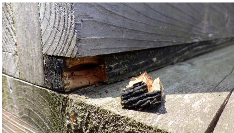
写真 15 : (設置場所:つくば／無処理材) 北面と水平面の取り合い部の腐朽
