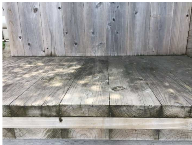
写真 14 : (設置場所:大阪／防腐処理材) 水平面に生じたカビ、ラミナの干割れ
