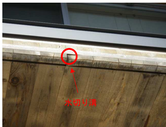
南側軒裏(ラミナ破損部分)
