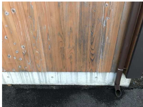
基礎取り合い部分(退色・雨染み)
