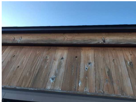
破風部分(雨汚れ)
