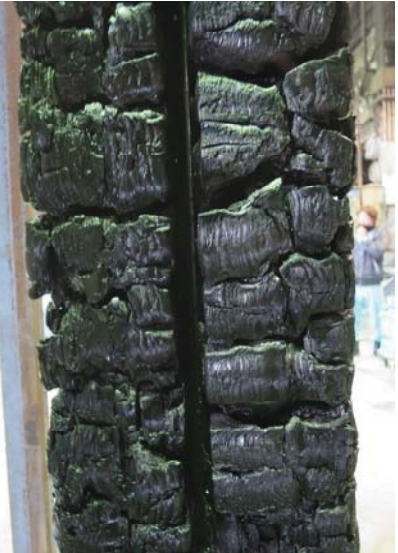
写真 5.2.4-9 消火後の柱間の状況
