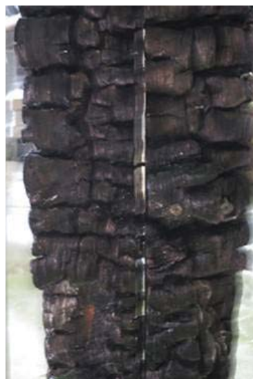
写真 5. 2. 4-3 消火後、柱間の状況
