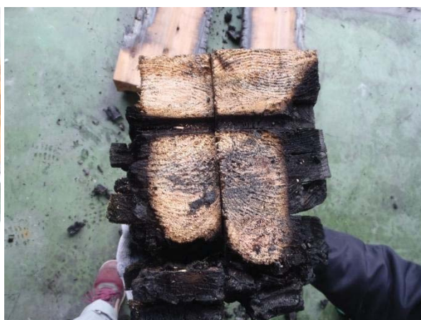
写真5.1.4-16 ボルト部分の燃え込み
