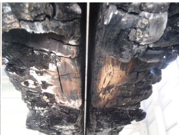
写真5.1.4-6 はり下面の隙間状況
